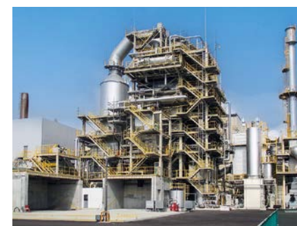
廃棄物焼却設備
